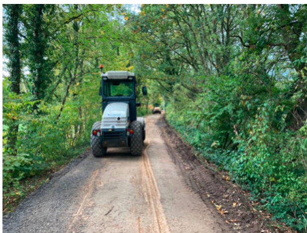
Rheinischer Esel: Da der beliebte Geh- und Radweg im Landschaftsschutzgebiet liegt, darf nur zwischen Oktober und Februar gebaut werden.
