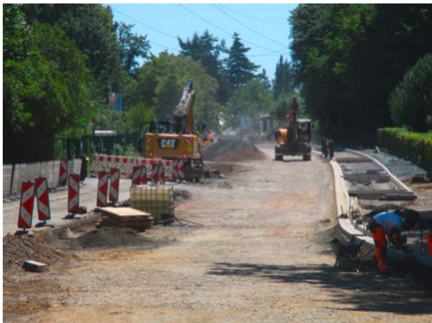
Planetenfeldstraße: Die Maßnahme war Bestandteil eines interdisziplinären Pilotprojekts mit dem Ziel, die Gesamtbauzeit so kurz wie möglich zu halten. Bis zu fünf Kolonnen der verschiedenen Baufirmen arbeiteten parallel.
