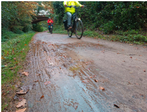
Rheinischer Esel: Beständiger Regen sorgt dafür, dass die wasser-gebundene Oberfläche aufweicht und Schäden nimmt. Pfützen und Schlaglochbildung sorgen für einen erhöhten Unterhaltungsaufwand und erschweren den Alltagsradverkehr.
