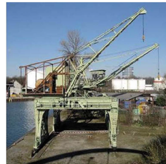
zu sanierender Portalrehrkanal
