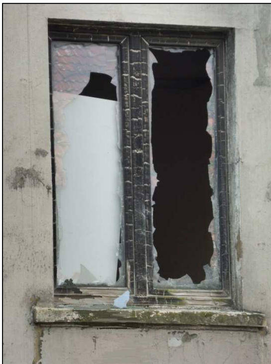
Problemimmobilie, Bornstraße Foto: Stadt Dortmund, Amt für Wohnen und Stadterneuerung
